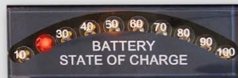
Las baterías tienen una carga del 20%
